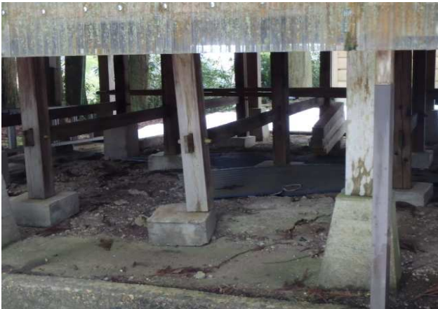
・渡り廊下の基礎が傾きつつある
