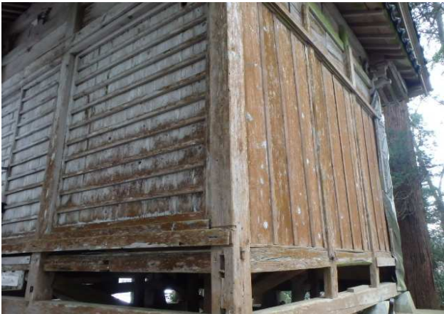
・奥殿(右側)の側面・虫による穴が多くみられる
