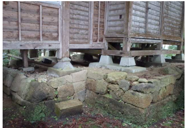
・奥殿の基礎・やり変えた基礎も割れている所がある
