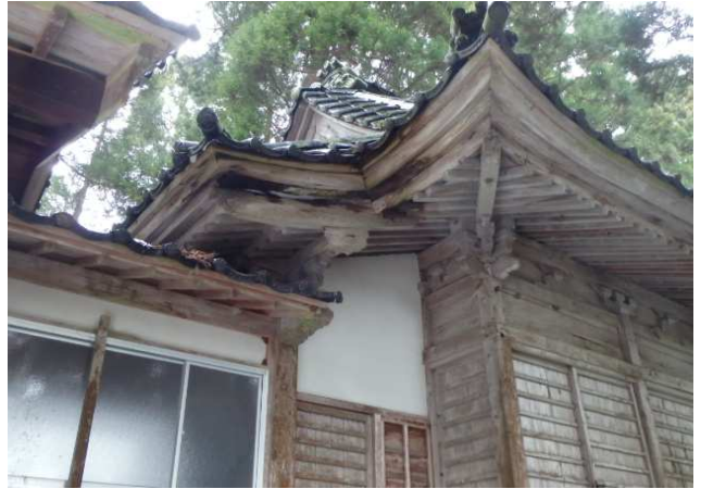
・奥殿(左手前)の垂木等が腐りかけている。
