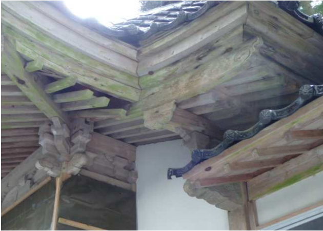
・奥殿(右手前)の垂木が腐って落ちかけている
